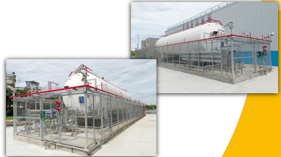
新竹-山葉機車60m 3 臥式儲罐
